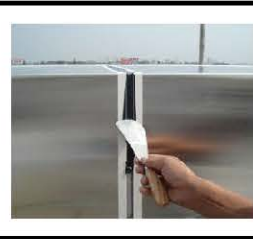
ปาดซิลิโคนเพื่อไม่ให้มีช่องว่าง fullfill the sealant for nonspace
