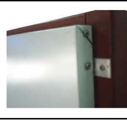
ใช้ฉากยึดแผ่นให้ติดกับโครงสร้าง fix the panels to the structure
